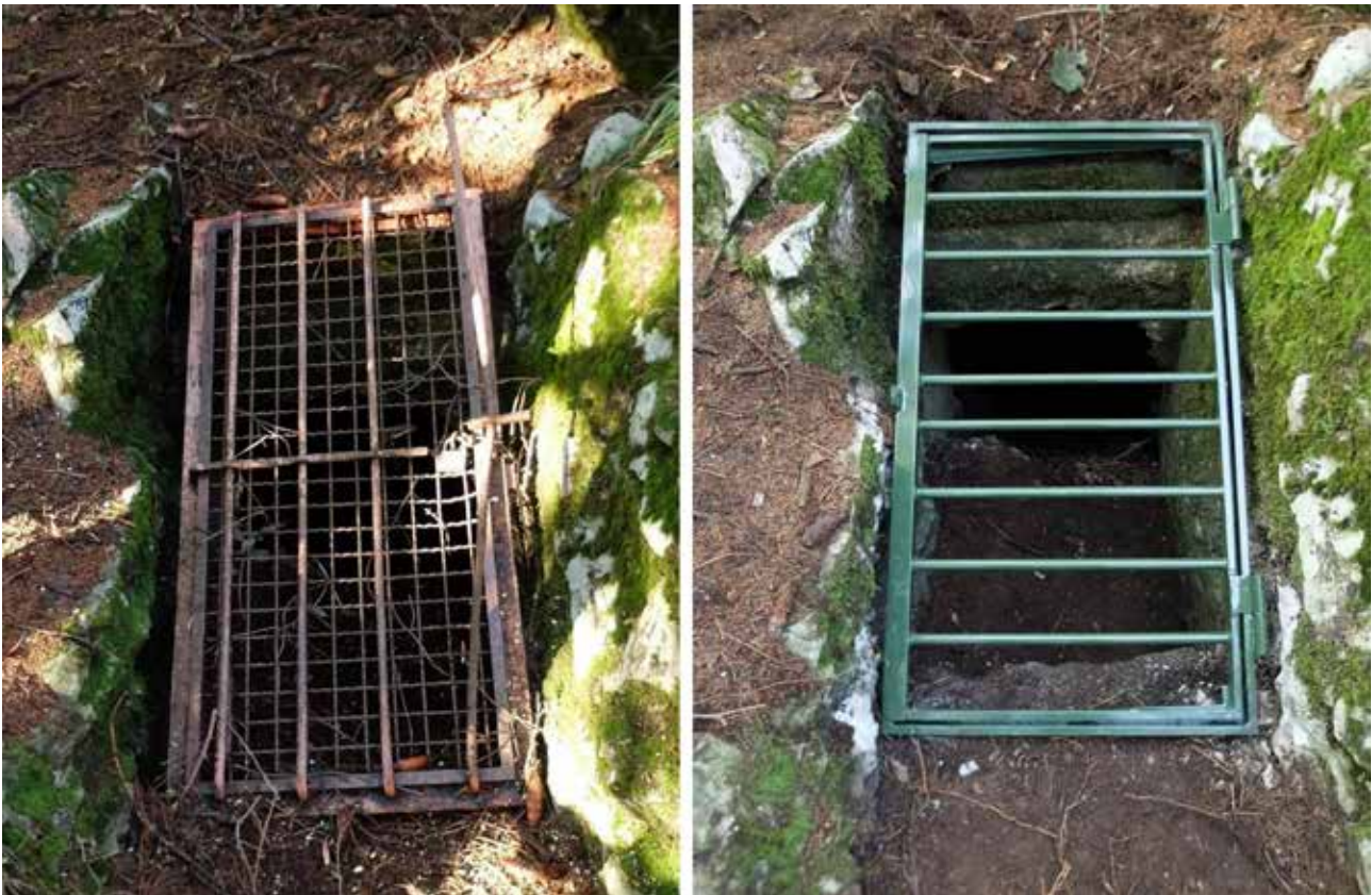
Figura 1 – Grotta di Cima Paradiso, confronto del cancello d'ingresso prima e dopo l'intervento (foto Andrea Ferrario)
